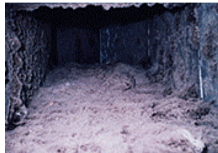
Kanal in Benutzung (es kann passieren, dass der Schimmel den Kanal fast ganz verstopft)
